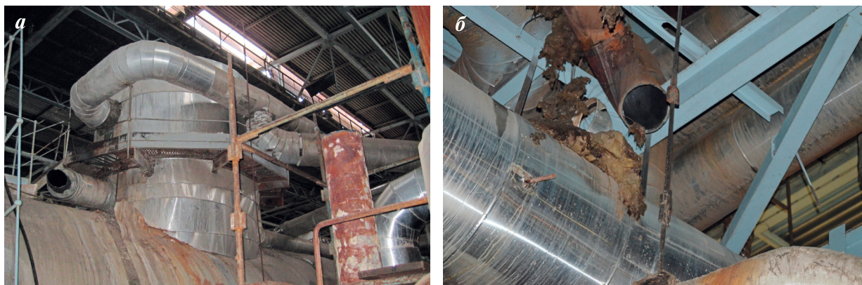
Рис. 30, а, б. Место разрушения паропровода греющего пара блока № 2 филиала «Самарская ТЭЦ» ОАО «Волжская ТГК»
