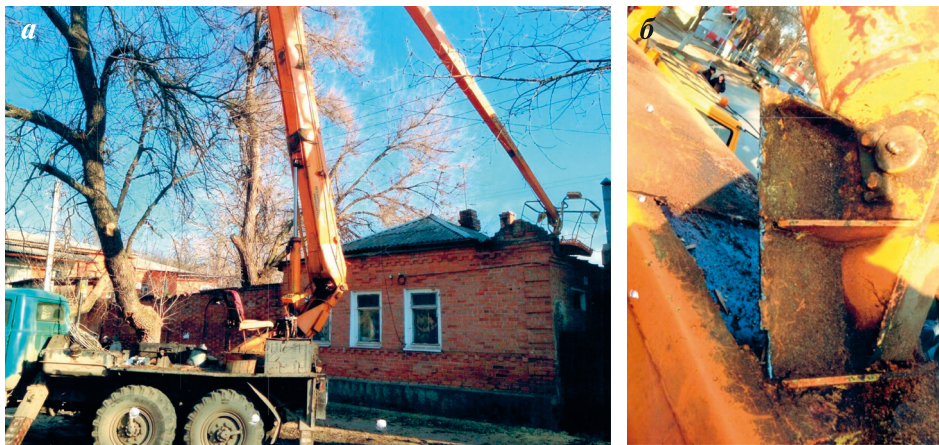
Рис. 56. Падение люльки автогидроподъемника ВС-22 на крышу одноэтажного здания: а — картина аварии; б — место отрыва кронштейна крепления гидроцилиндра
