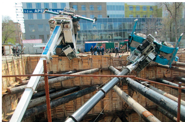
Рис. 49. Падение груза на дно котлована и опрокидывание кранов СТ 2-2-40 на верхний ярус расстрелов котлована
