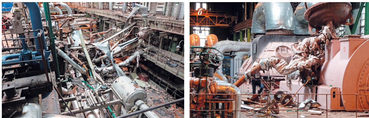
Рис. 31, а, б. Виды последствий аварии подогревателя высокого давления № 7 в машинном зале энергоблока № 2 филиала ОАО «ИНТЕРРАО-Электрогенерация» Черепецкой ГРЭС
