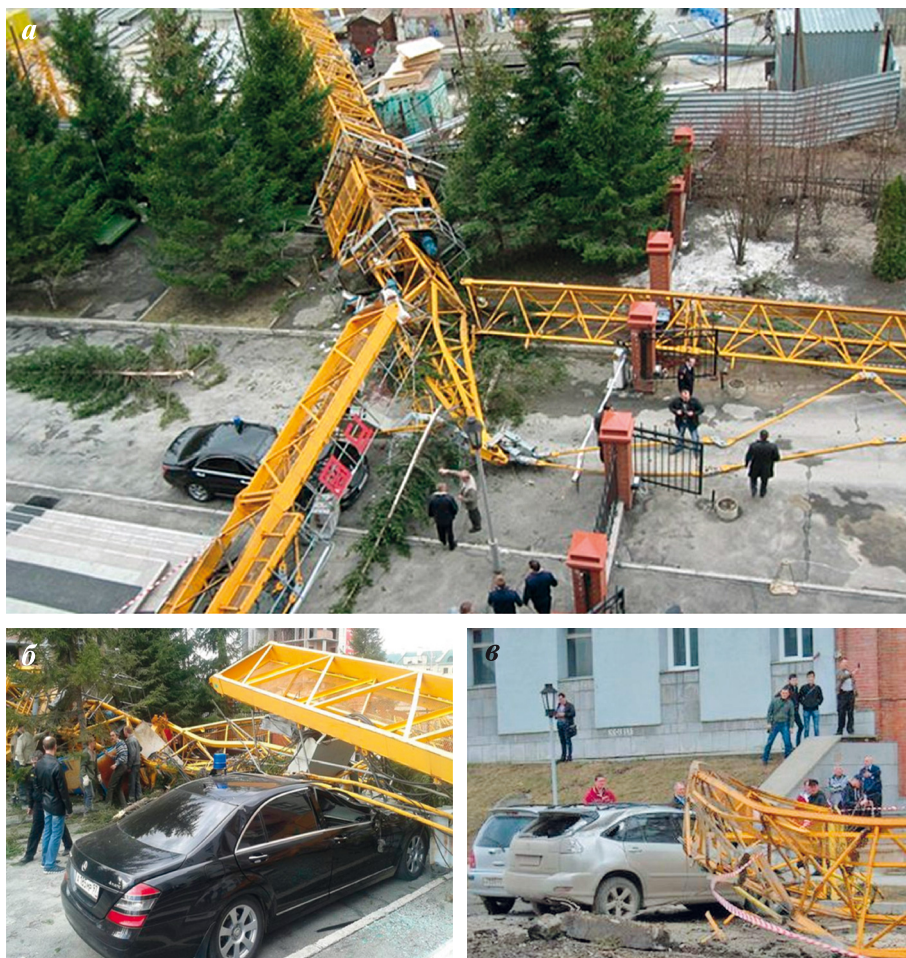
Рис. 59. Падение крана на площадке строительства жилого дома в г. Новосибирске: а — общий вид упавшего башенного крана QTZ-80; б, в — повреждение припаркованных машин
